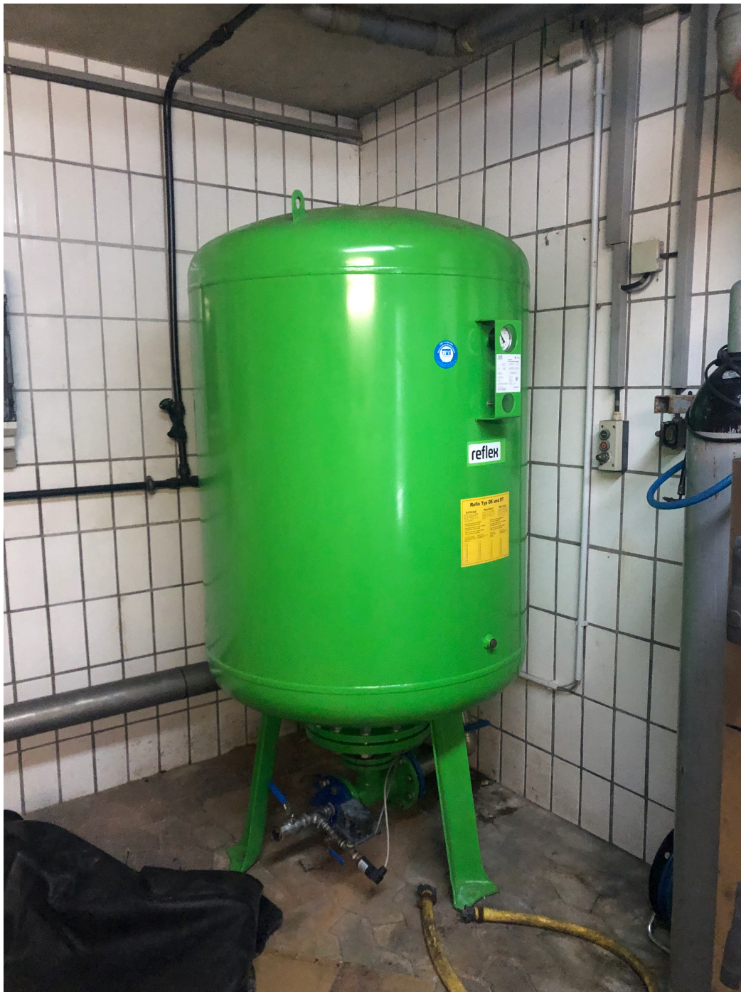
Druckausgleichsbehälter für die Brauchwasseranlage
