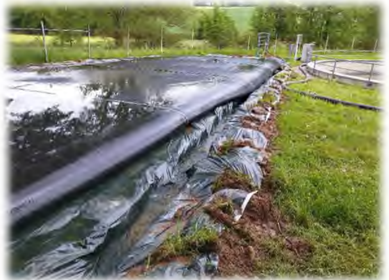
Ausweichbehälter für den Klärschlamm während der Umbauphase
