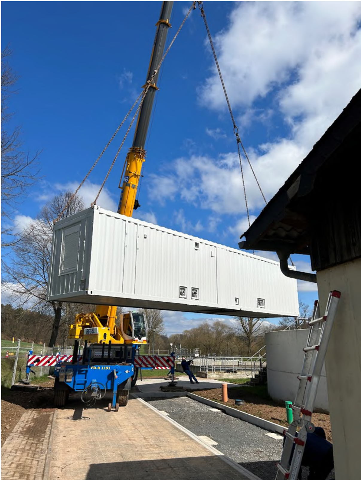
Anlieferung des neuen Schlammpressen-Containers zur Erhöhung des TS-Wertes
